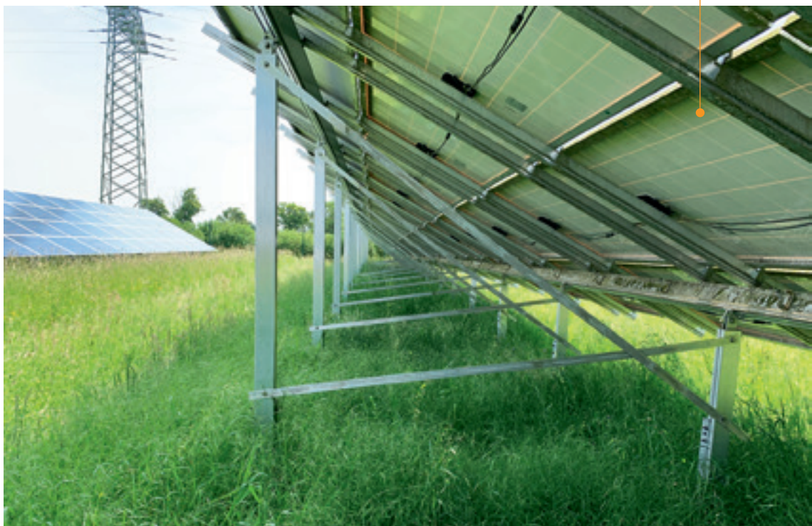
Aufständerung wie im Solarpark Olching/Bayern
