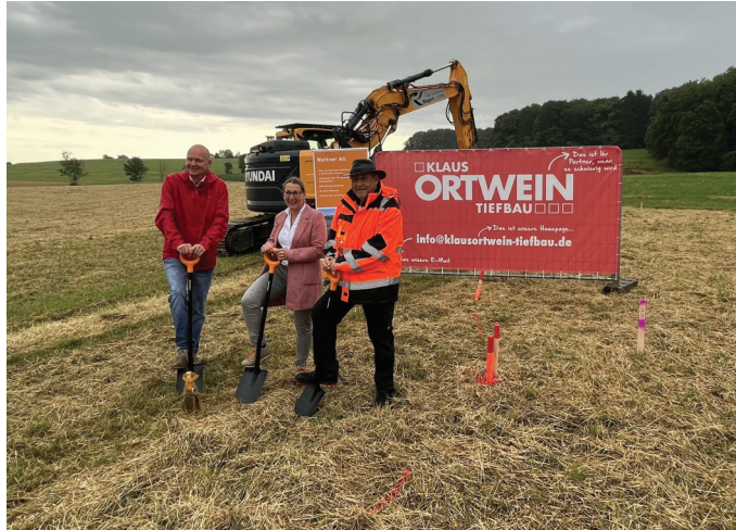
Spatenstich für den neuen Solarpark in Staufen (von links): Wattner-Projektentwickler Thomas Schneider, Syrgensteins Bürgermeisterin Mirjam Steiner und Wattner-Bauleiter Torsten Dölitzsch. © Foto: Wattner
